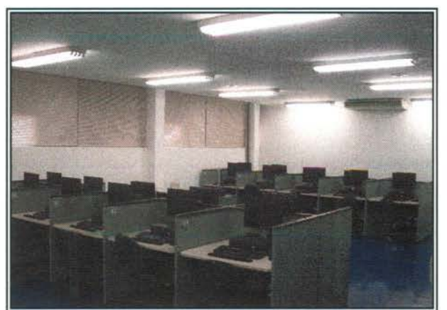
Central de Processamento de Dados
